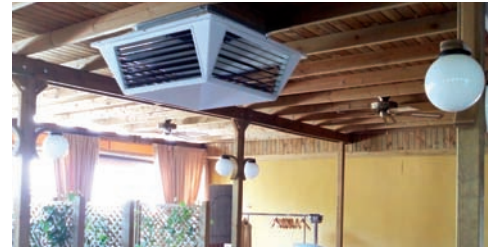
Climatización de carpas y terrazas
